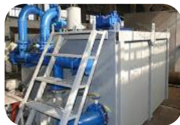
Блоки циркуляционных систем
